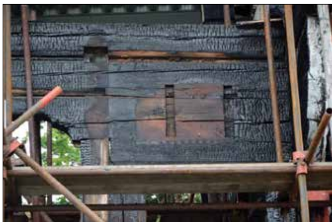
Obr. 3. Roubení nad hlavním průčelím nad vstupem do jídelny. Po odstranění kartuše s malovanými rostlinnými motivy je dobře viditelný původní červený nátěr. Foto Luděk Dvořák Timbering above the main façade above the entrance to the dining hall. The original red-coloured paint is clearly visible after the removal of the cartouche. Photo taken by Luděk Dvořák
