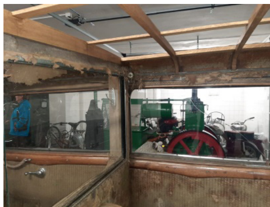
Obr. 7 Nedokončený zásah do konstrukce střechy / Unfinished intervention in the roof structure
